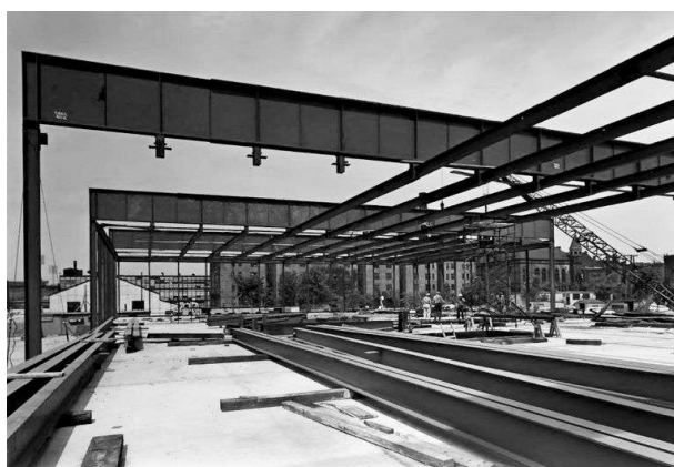
Mies van der Rohe : le Crown Hall en construction sur le campus de l'Institut de technologie de l'Illinois (IIT) à Chicago dans l'Illinois, USA (1950-1956)
